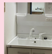
WASH BASIN 洗面台 建物によりスタイルが違います。 Style may be different in each building.
